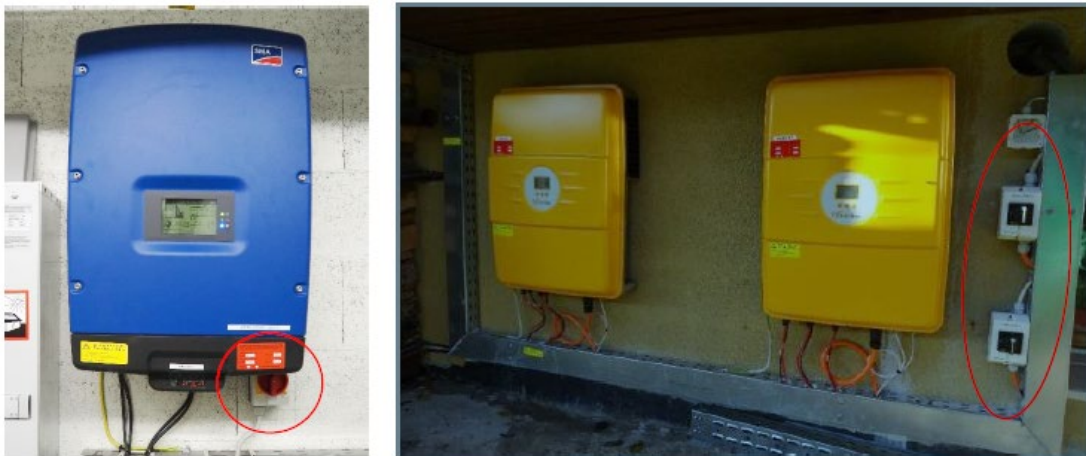
Ryc. 10. Przykłady lokalizacji rozłączników prądu AC za falownikiem
