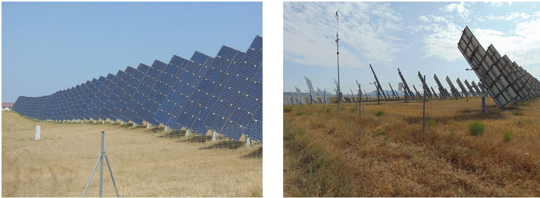
Ryc. 5. Panele PV w instalacji obrotowej
